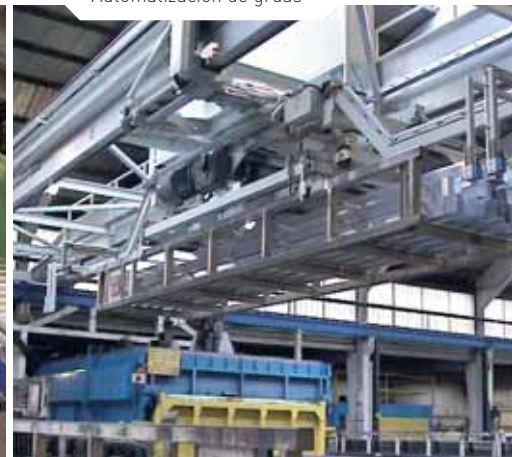
Automatización de grúas
